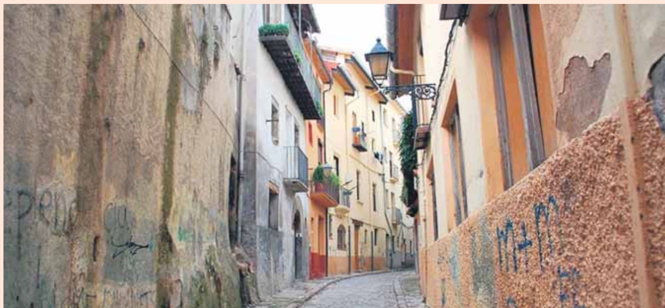
Un carrer de Gironella amb algunes façanes deteriorades. ARXIU
